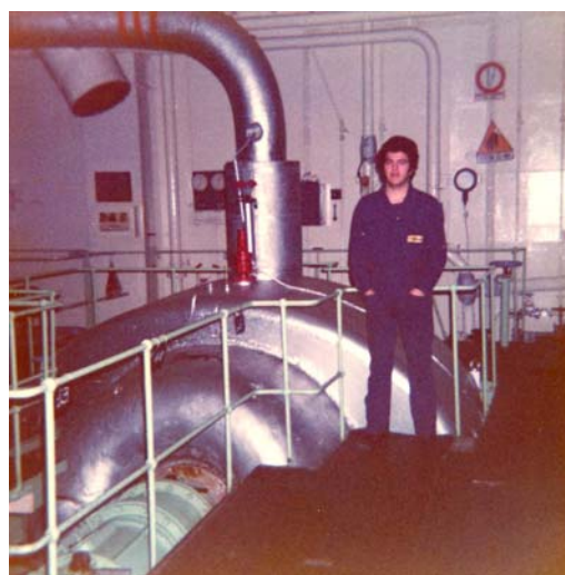
Sala Macchine: La turbina di bassa pressione
