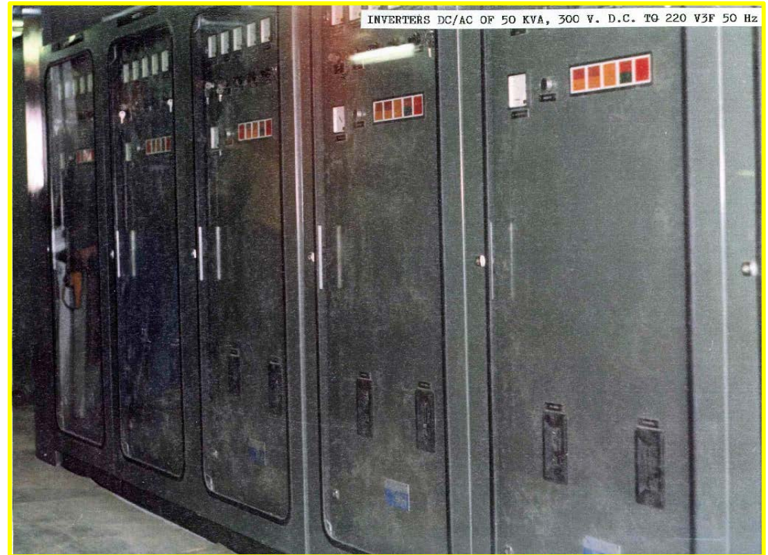
Inverters e carica batterie
