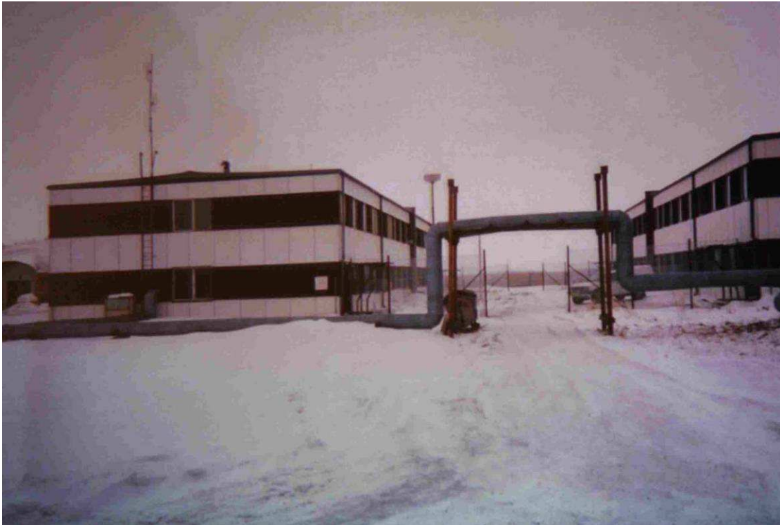
Il tubo per la distribuzione dell'acqua di riscaldamento come parte dell'ingresso al compound
